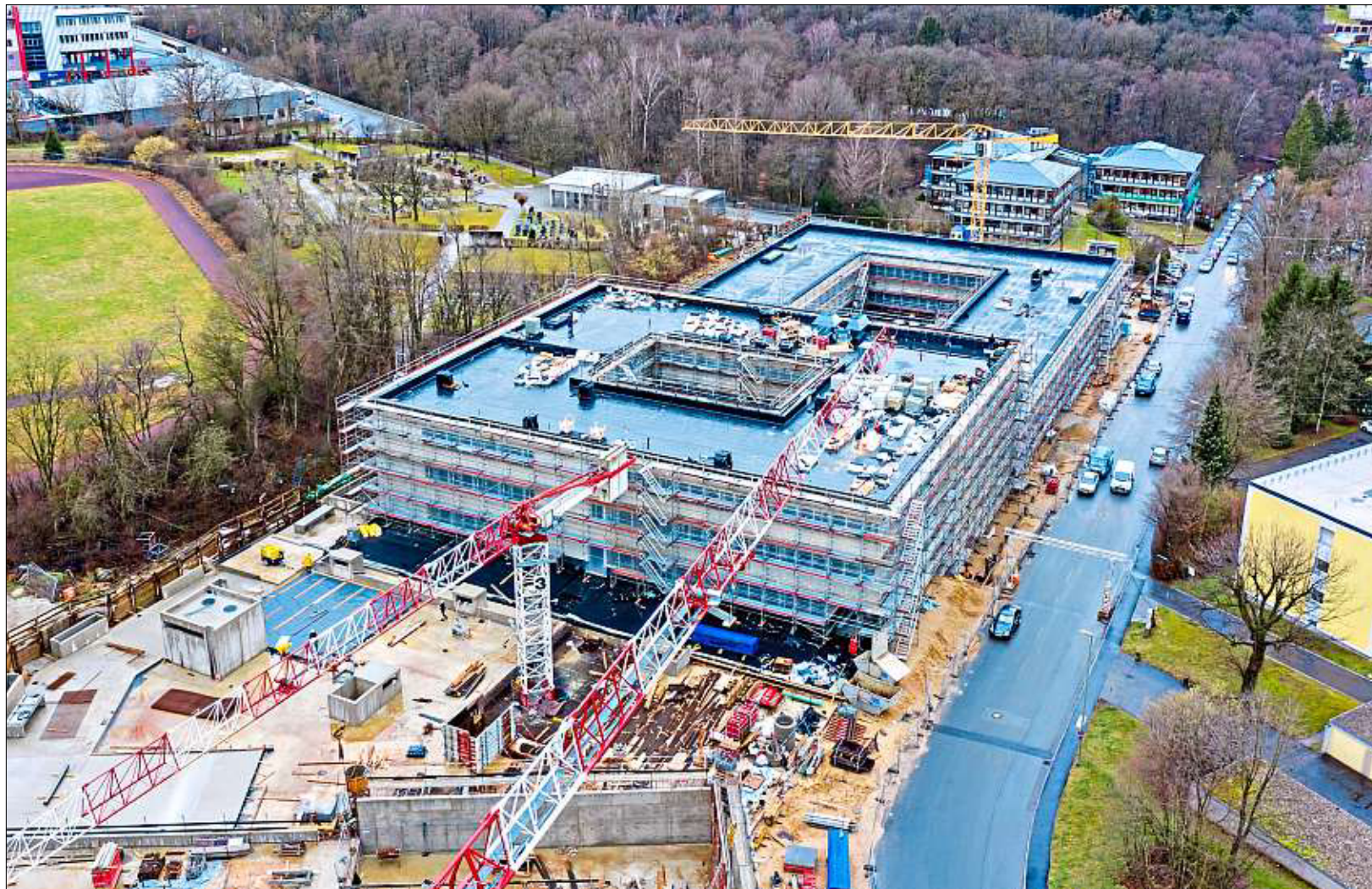
Das neue Polizeigebäude an der Karlsbader Straße aus der Luft betrachtet: Auch wenn sich die Fensterlieferung wegen der Corona-Krise verzögert, der geplante Termin für die Fertigstellung Ende 2021 steht nach wie vor. – Fotos: © Matthias Kinateter, StBA Passau
