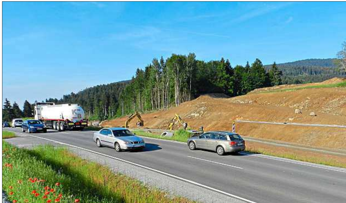
Aktuell fließt der Verkehr auf der Bundesstraße 11 bei Hochbühl über eine eigens errichtete Behelfsfahrbahn. Im Hintergrund sind die Reste des ehemaligen Waldstücks zu erkennen, das ebenso wie rund 6500 Lkw-Fuhren Erdreich abgetragen wurde. Die neue Fahrbahn der B 11 wird um vier Meter tiefer liegen. – Foto: Klotzek
