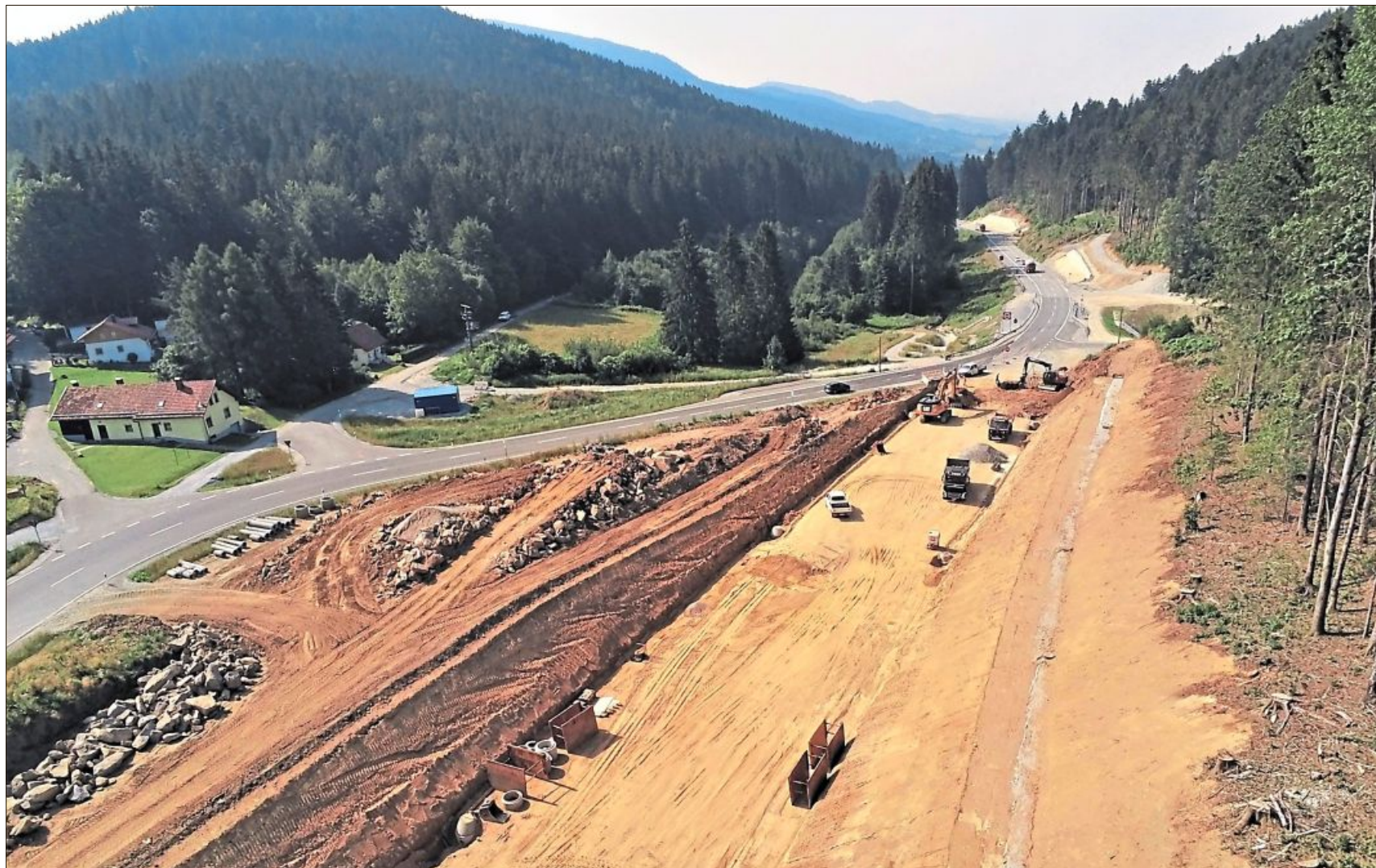
Neben der A3 liegt der Schwerpunkt derzeit auf der B11. Unser aktuelles Bild zeigt die gegenwärtige Situation bei Hochbühl.
