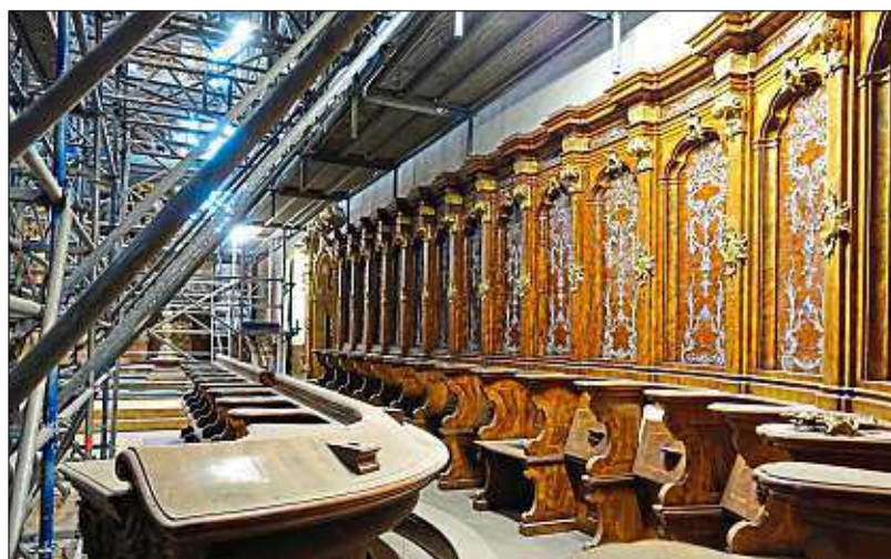
Die Gerüstbauer mussten eine Lösung für das Chorgestühl finden, das nicht wie anderes Inventar abgebaut wurde.
