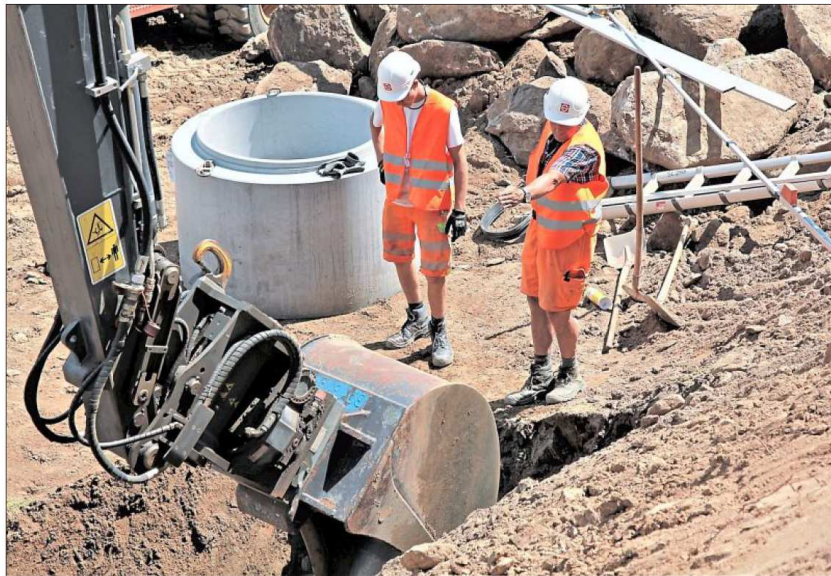
So mächtige Baugeräte zur Verfügung stehen, so unentbehrlich ist (immer noch) die Arbeit von Menschenhand.
