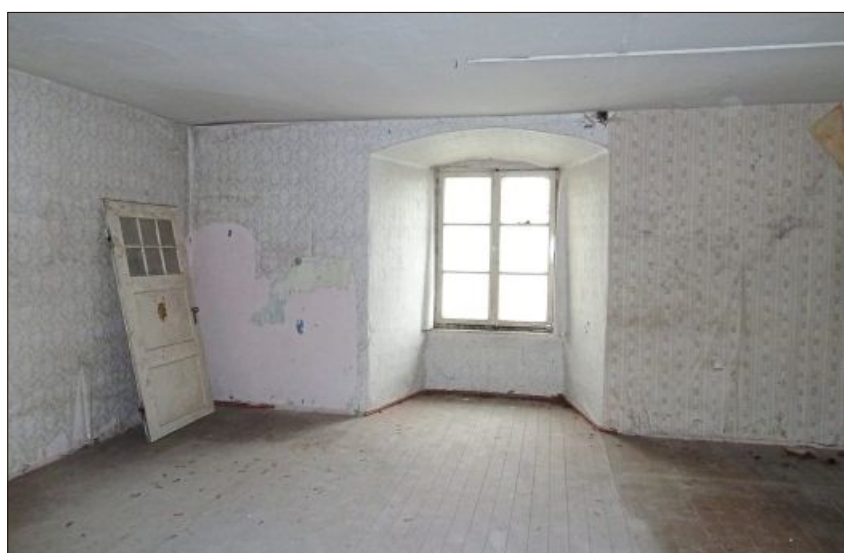
Die Räume brauchen eine grundlegende Sanierung: Zuletzt waren sie in der Nachkriegszeit bewohnt.
