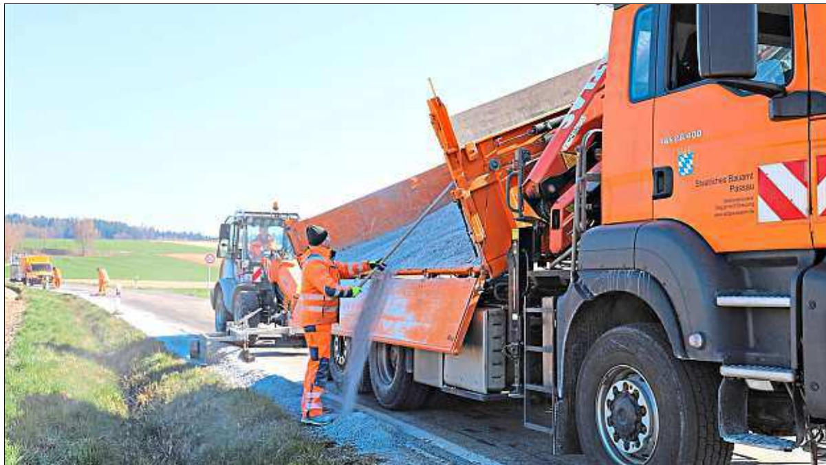
Auf der Staatsstraße 2115 zwischen Göttersdorf und Altenmarkt wurden Risse in der Straße repariert. Die Mitarbeiter der Straßenmeisterei Deggendorf richten das Bankett her. – Foto: Staatliches Bauamt Passau
