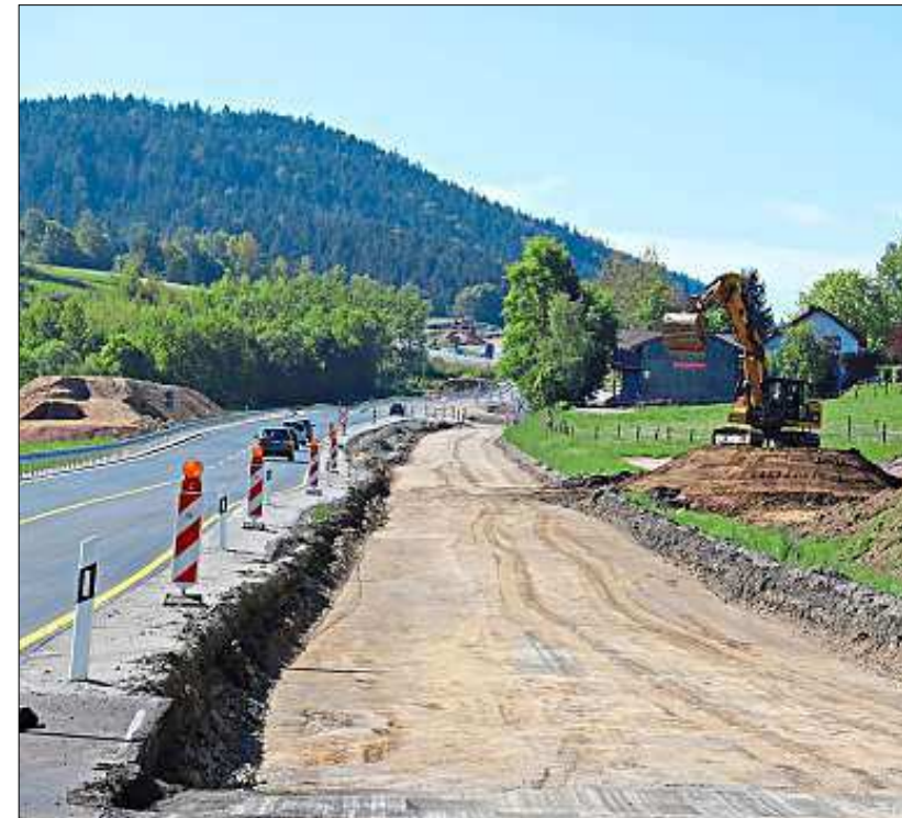
Die alte B 11 ist verschwunden. Die frühere Trasse wurde ausgekoffert, dort wird ab Juni ein Regenrückhaltebecken gebaut.
