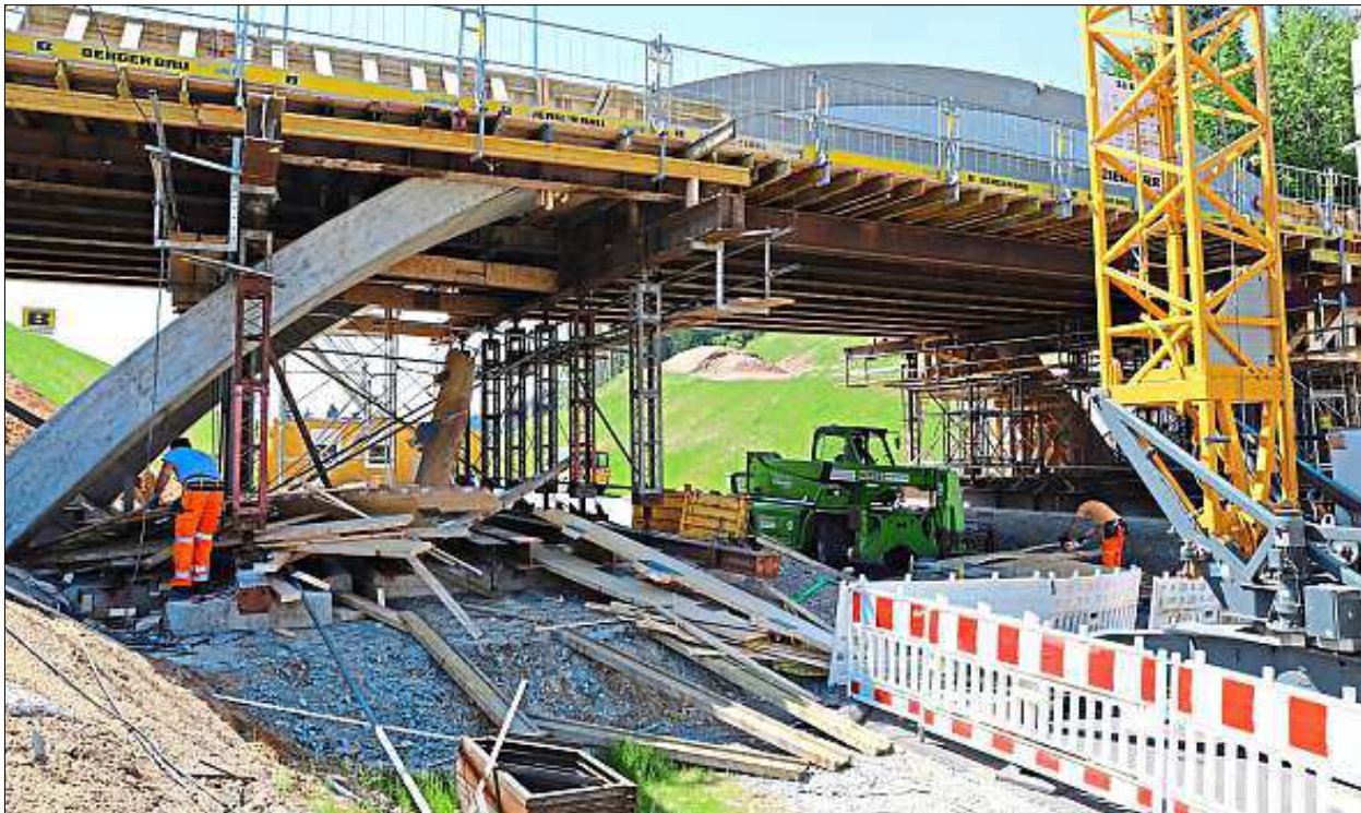
Das Tor zum Bayerischen Wald ist bereits zu erkennen. Unter der neuen Brücke bei Hochbühl haben die Arbeiter damit begonnen, die Schalung der Bögen abzubauen. – Fotos: Sabine Süß/StBA
