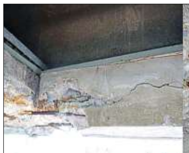
Risse, Betonabplatzungen und freiliegende Bewehrungsteile: Nahezu die gesamte Brücke ist von den Schäden betroffen.
