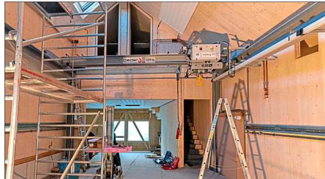
Die neue Werkstatt der Dombauhütte ist ein weiteres Großprojekt, die Planer haben sich für eine Holzkonstruktion entschieden. – Fotos: Staatliches Bauamt Passau/Kinateder
