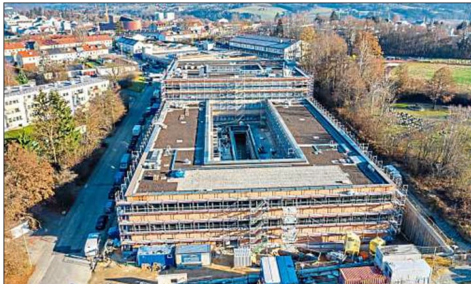
Der Neubau für die Landespolizei in Passau war im vergangenen Jahr die größte Hochbau-Baustelle des Staatlichen Bauamts Passau.
