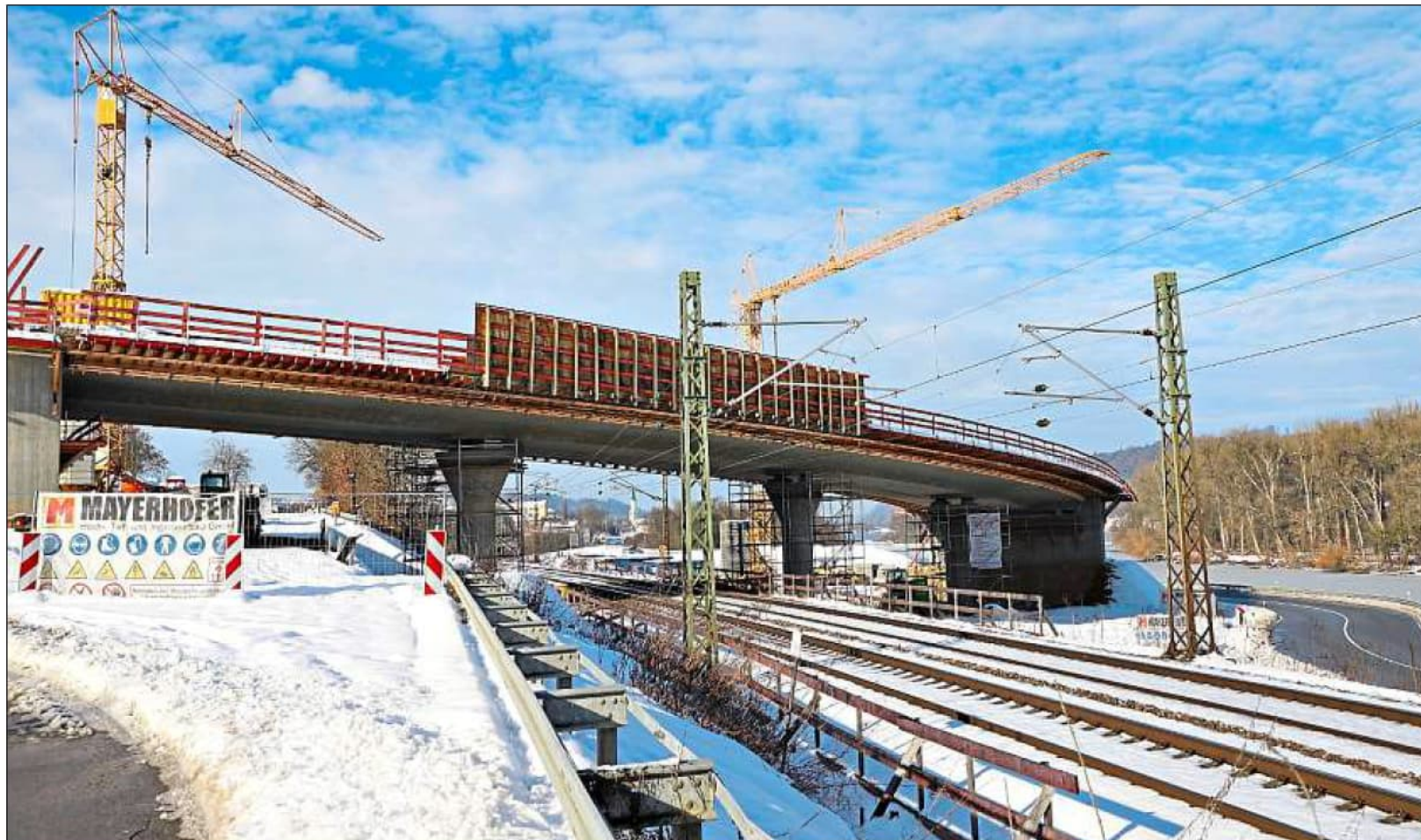
Im Moment ist Winterpause auf der Ortsumfahrung Vilshofen: Die Absenkung des Überbaus an der Brücke über die B 8 und die Bahnstrecke konnte im vergangenen Jahr noch abgeschlossen werden. – Fotos: Staatliches Bauamt
