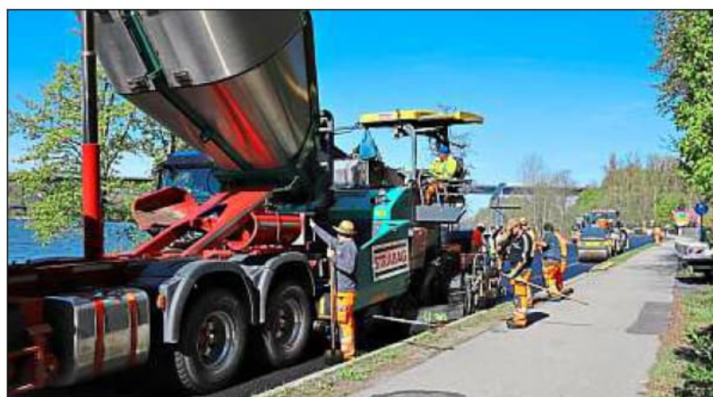
Die Fahrbahn der St 2125 bei Zieglstadt wurde erneuert, dabei wurde in einem Teilbereich lärmindernder Asphalt aufgebracht.
