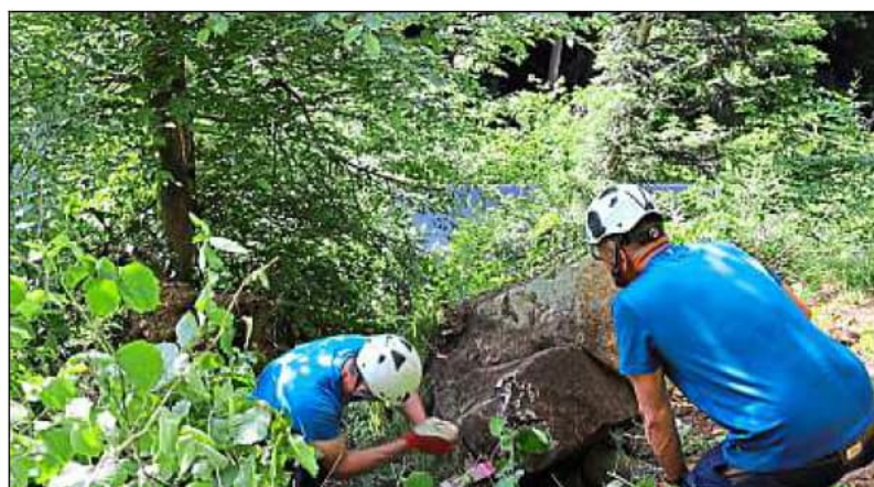
Mehr Sicherheit: Große Felsbrocken wurden von einem Hang an der Staatsstraße 2127 bei Wlndorf geräumt.
